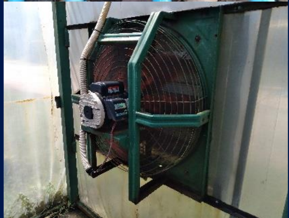
ภาพที่ 9 ถังบรรจุน้ำ ปั๊มน้ำ วาล์วน้ำ ไฟฟ้า และพัดลม
